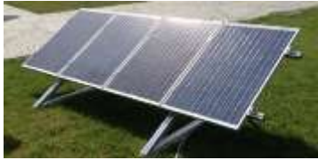
Şekil 8. Sistemde kullanılan Güneş Panelleri.
